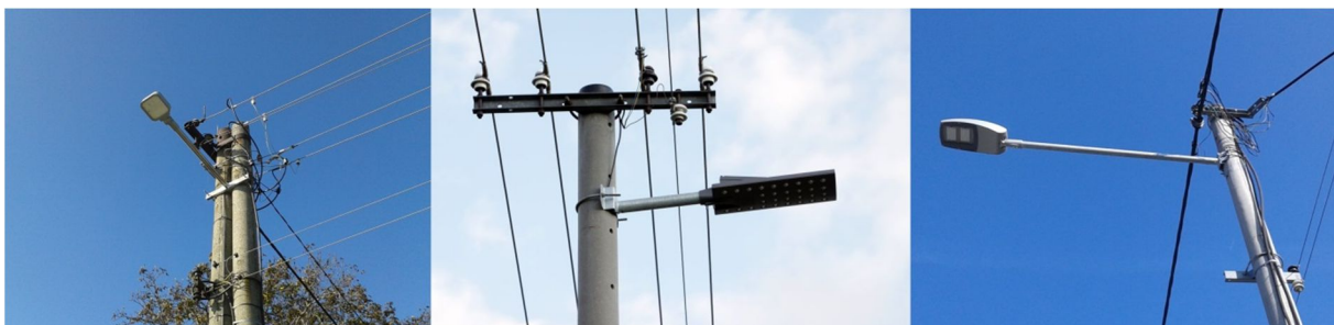
Obr.3 Príklady inštalácie LED svietidla na rozvode NN v obci
